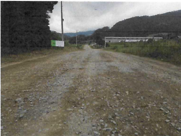
Imagem 09: Placa instalada no ponto coordenada "A" na estrada da Localidade Boa Esperança. Possível observar material britado aplicado.
