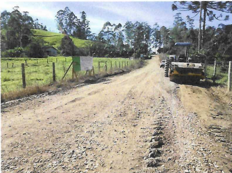
Imagem 20: Placa instalada no ponto coordenada "A" na Estrada da Localidade Rio Bandeira. Execução dos trabalhos de aplicação do material britado.
