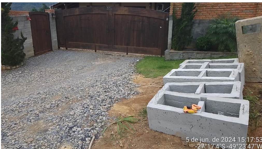
Imagem 23 e imagem 24: Caixa de captação com junção em alvenaria de tijolo maciço e concreto, caixa de inspeção em blocos de concreto.
