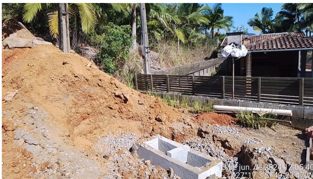
Imagem 24 e imagem 25: Caixa de captação com junção em alvenaria de tijolo maciço e concreto, escavação mecanizada, assentamento de tubo de concreto, camada de brita, reaterro.
