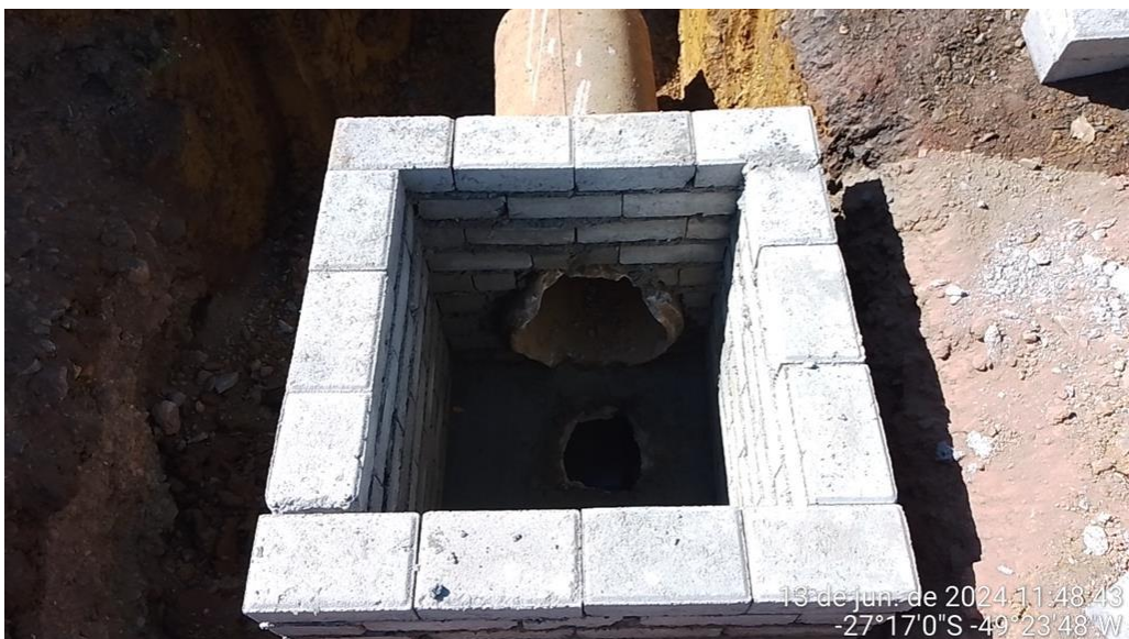
Imagem 28 e imagem 29: Caixa de inspeção.
