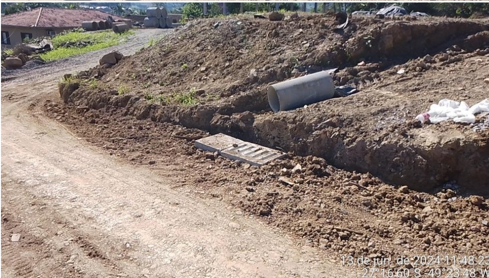
Imagem 25, imagem 26 e imagem 27: Caixa de captação com junção em alvenaria de tijolo maciço e concreto.
