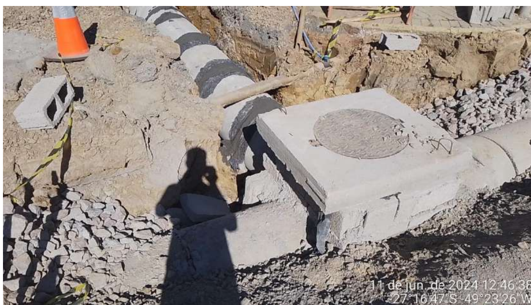
Imagem 97: Caixa de inspeção em blocos de concreto para tubos de dn 600mm com tampa de ferro fundido, incluindo materiais e serviço.
