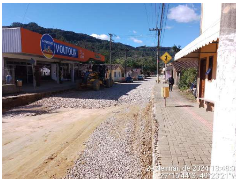
Imagem 66: Regularização e compactação de subleito com uso de motoniveladora, execução e compactação de base e ou sub base com macadame seco.
