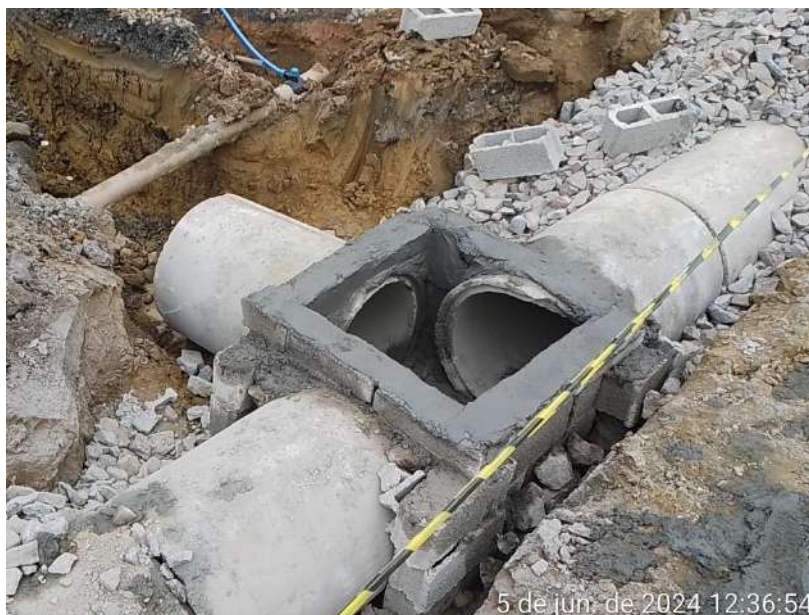
Imagem 88: Caixa de inspeção em blocos de concreto
