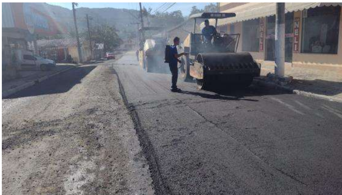
Imagem 08: Execução de imprimação com asfalto diluído cm-30. Mobilização de equipamentos para obras de pavimentação asfáltica. Desmobilização de equipamentos para obras de pavimentação asfáltica.
