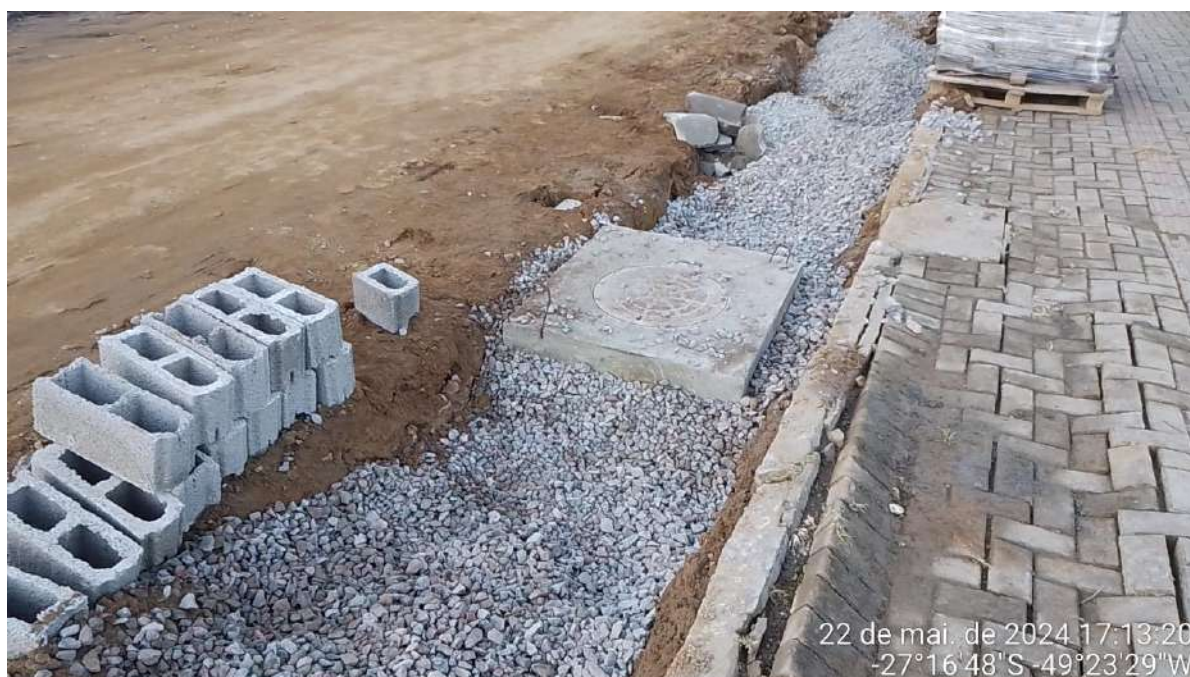
Imagem 38 e imagem 39: Caixas de inspeção e junção.
