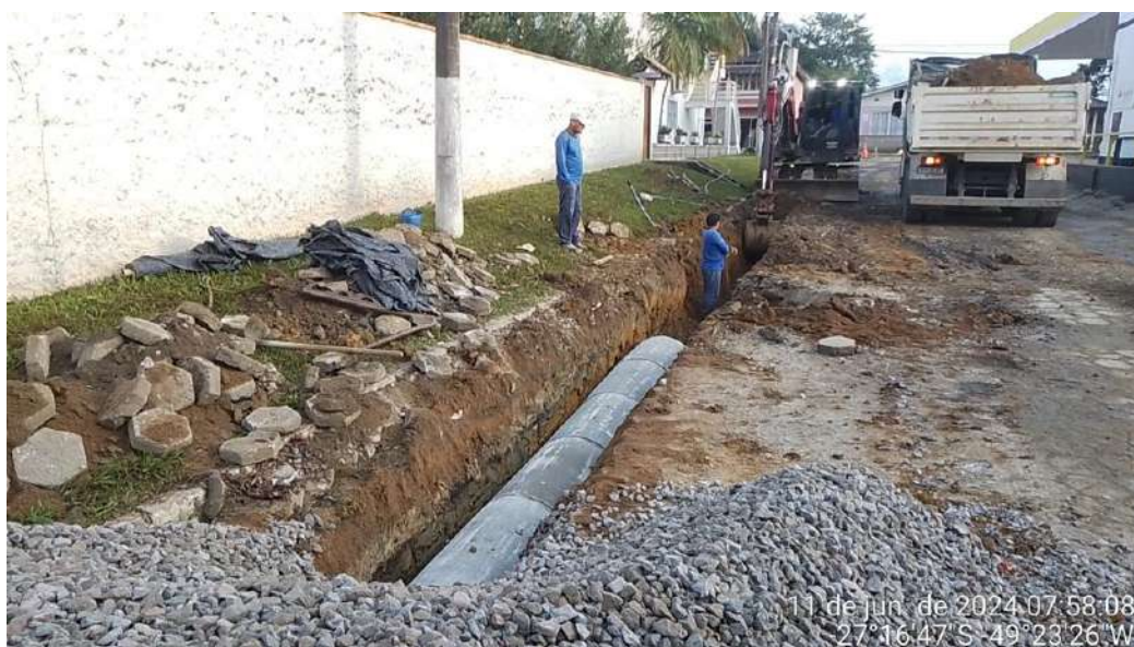
Imagem 28 e imagem 29: Assentamento de tubo de concreto dn 600mm com Camada de brita n. 2, e=10cm, fornecimento e colocação situado na rua José Andrade. Previsto na planilha de aditivo.
