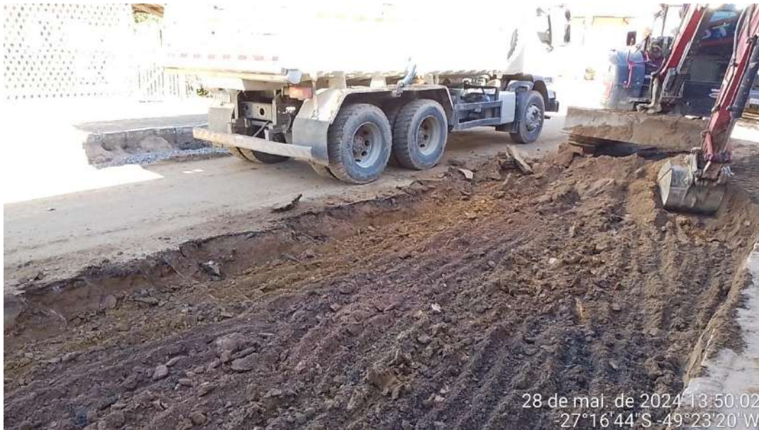
Imagem 52: Escavação horizontal com trator de esteiras, incluindo carga e descarga de solo.
