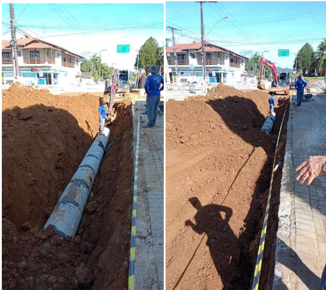
Imagem 18 e imagem 19: Tubo de concreto simples dn500 mm. Assentamento de tubo de concreto rejuntados com argamassa. Execução e compactação de reforço de subleito.
