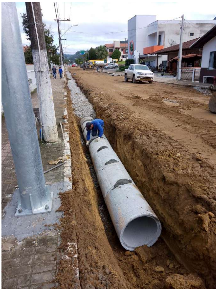
Imagem 11: Tubo de concreto, Assentamento de tubo rejuntados com argamassa, Camada de brita, Reaterro das valas com brita.
