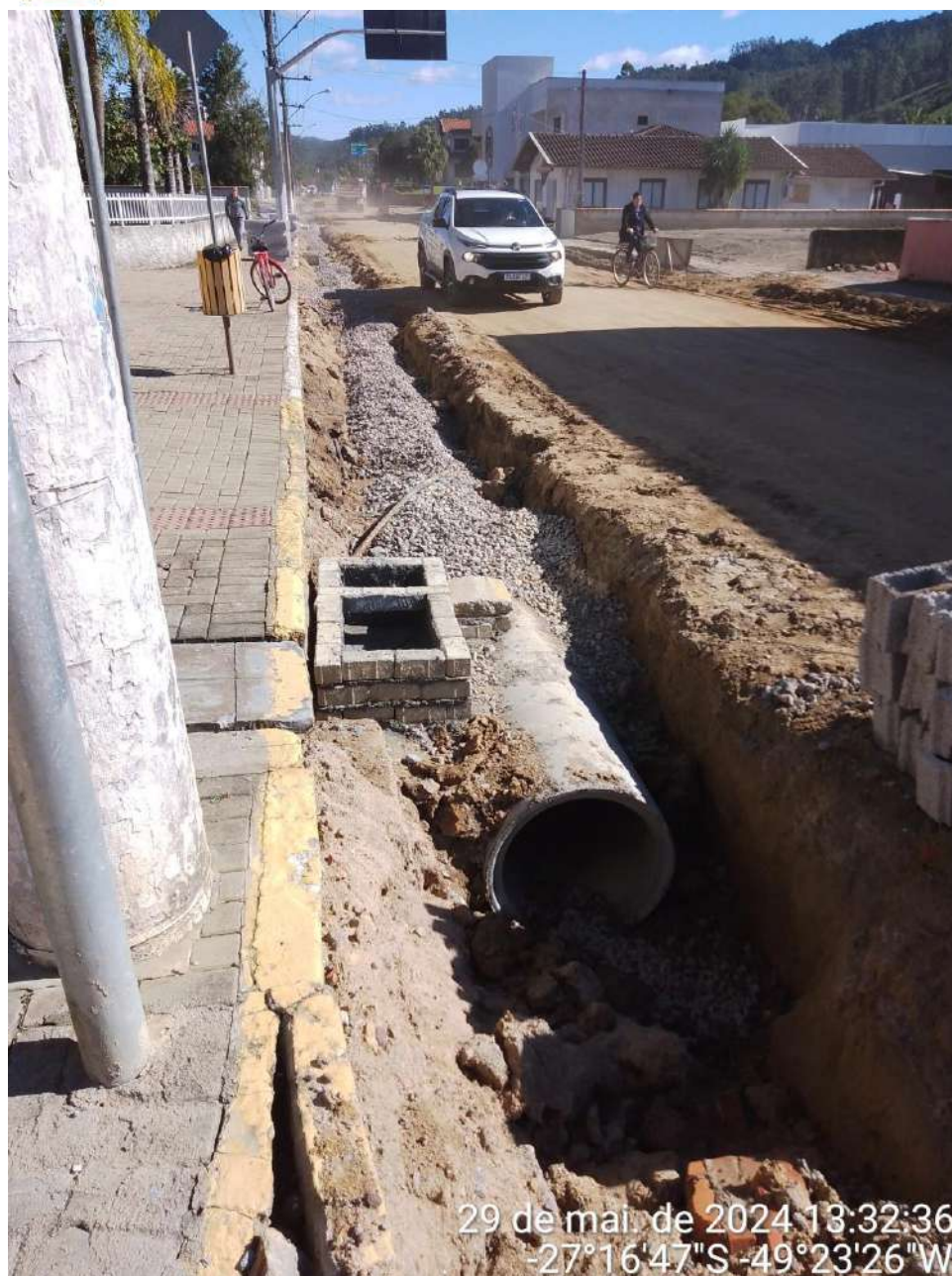
Imagem 67: caixa de captação com junção em alvenaria de tijolo maciço e concreto para tubos dn 600mm, incluindo materiais, serviço, escavação e reaterro. reaterro das valas com brita n. 2, fornecimento e colocação. Assentamento de tubo de concreto dn 600mm rejuntados com argamassa
