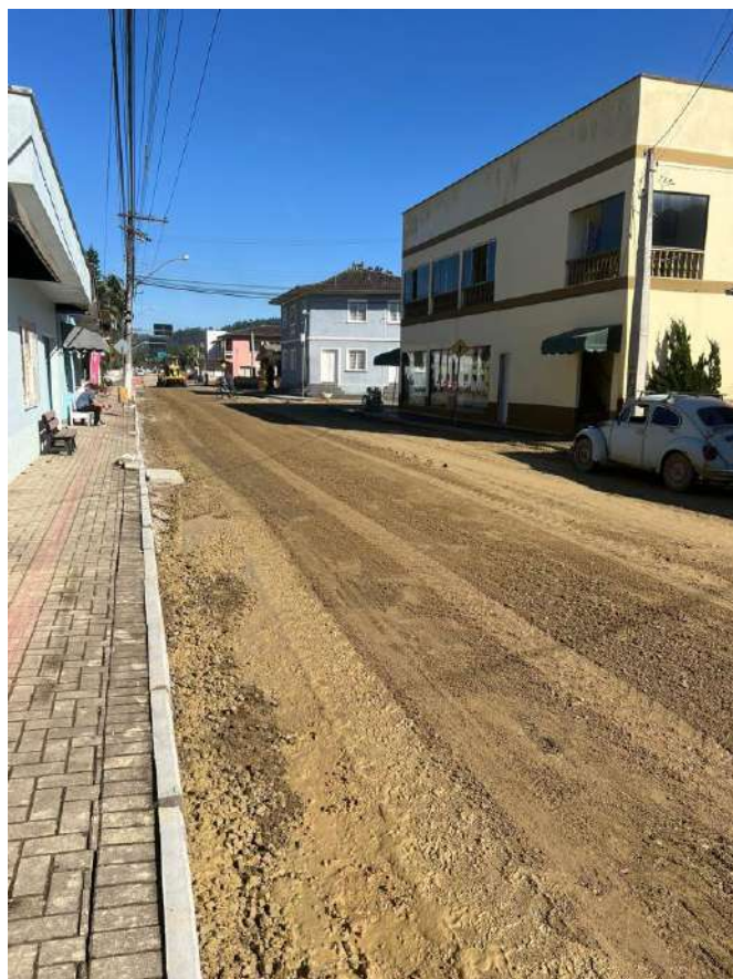
Imagem 02: Regularização e compactação de subleito de solo predominantemente argiloso. Af_11/2019. Execução e compactação de base e ou sub-base com macadame seco (com transporte).
