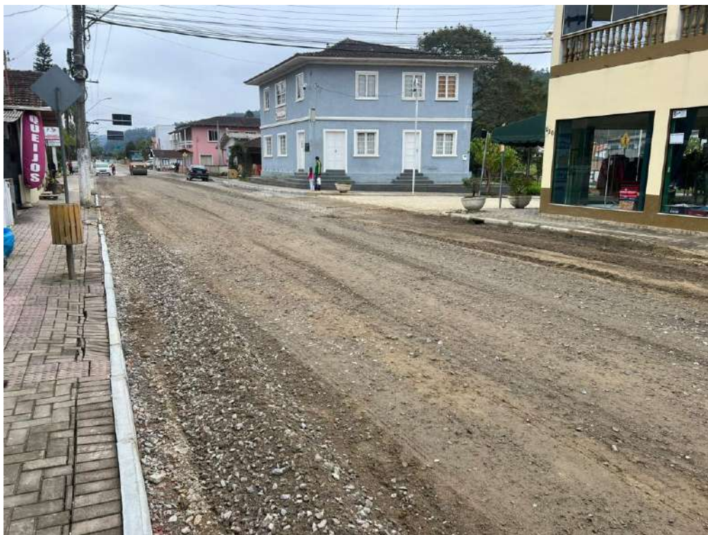
Imagem 03: Execução e compactação de base e ou sub base com brita graduada simples (com transporte).
