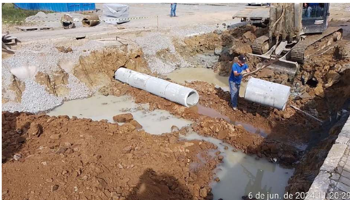
Imagem 07 e imagem 08: Assentamento de tubo de concreto dn 500mm rejuntados com argamassa
