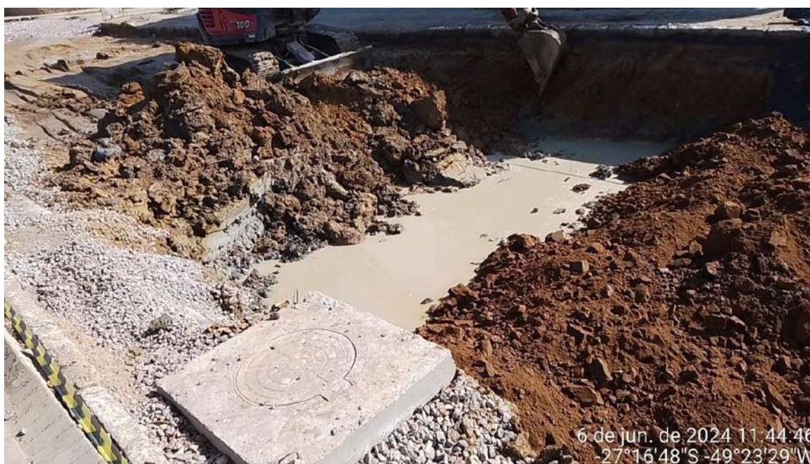
Imagem 03 e imagem 04: Escavação horizontal entre estacas 03 e 07, incluindo carga e descarga de material.
