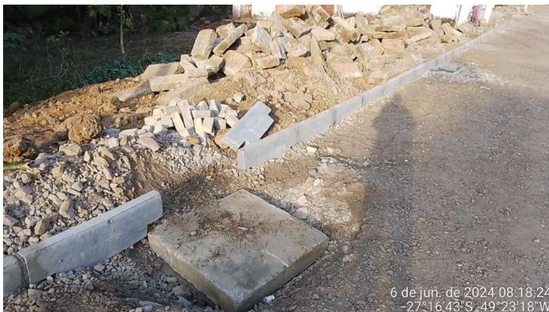
Imagem 96: Caixa de junção em bloco de concreto para tubos de dn 600mm, incluindo materiais e serviço.
