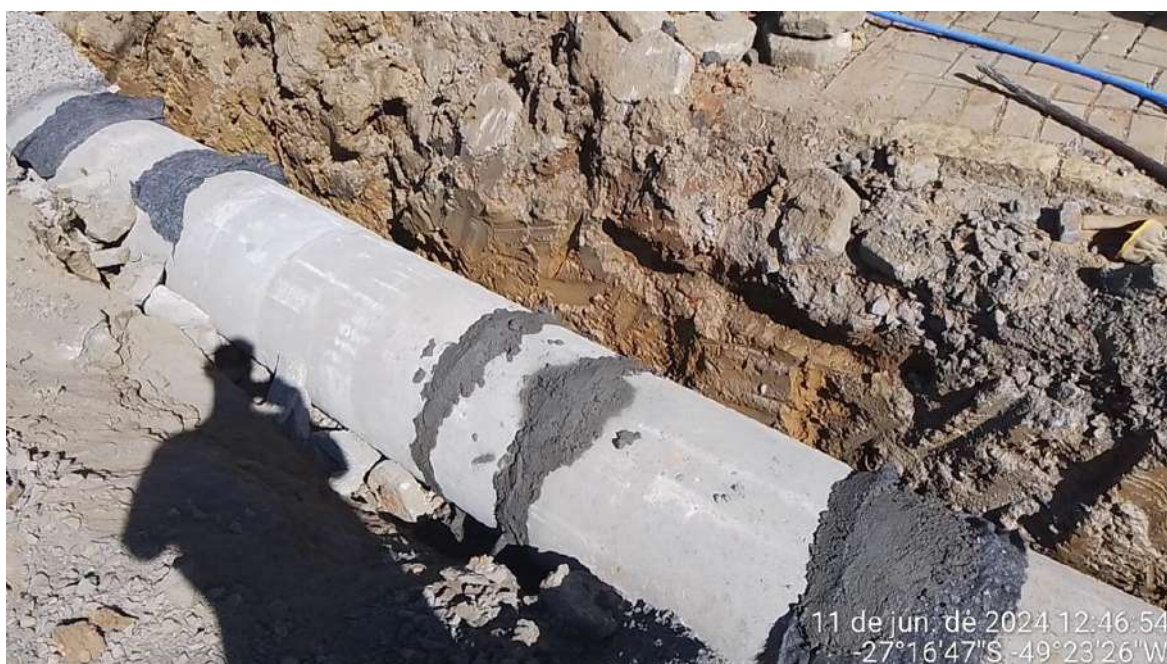
Imagem 32 e imagem 33: Observa-se assentamento de tubo de concreto dn 600mm rejuntados com argamassa
