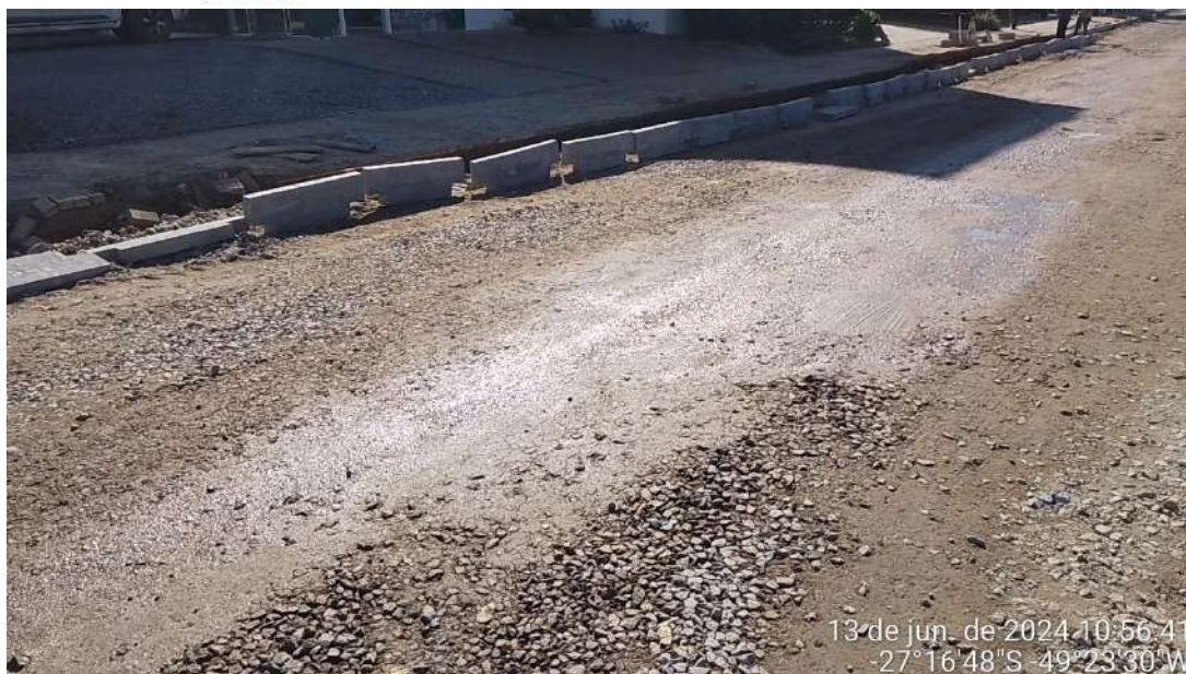
Imagem 102: Base e sub base com brita graduada simples executada e compactada. Colocação de meios-fios Pré moldado de concreto.
