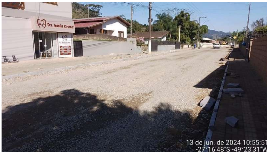
Imagem 101: Base e sub base com brita graduada simples executada e compactada. Meios-fios pré moldado de concreto executados.
