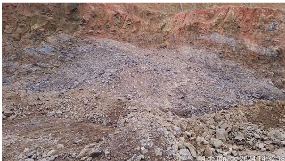
Imagem 01 e imagem 02: Escavação horizontal executada pela empresa no local do material fornecido pela prefeitura, incluindo carga e descarga deste material na Avenida Erico Torres. Coordenadas local de origem do material 27°16'59.0"S, 49°21'28.1"W.
